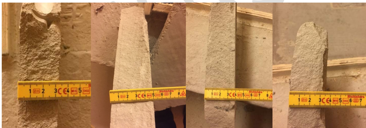
Foto 8: Faktisk målt tykkelse er mellom 32 og 47 mm ved riving. Tynnavretting er synlig, og målbar til 6-7 mm i alle fire bilder
